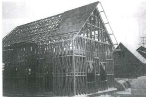
شکل ۱۱ خراباهای تشکیل دهنده‌ی سقف شیبدار
